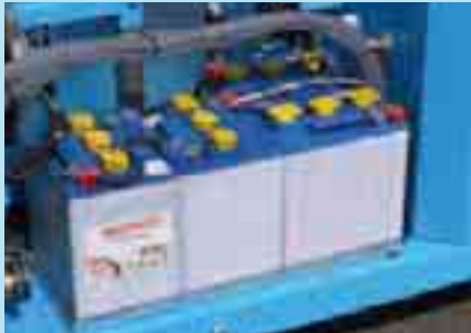
Gruppo batterie 24V. Unit batteries 24V.
